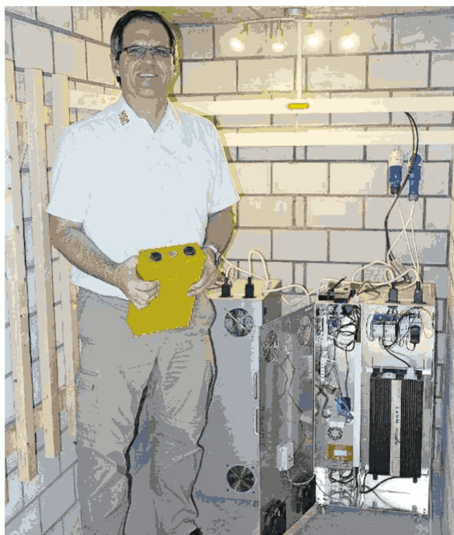
Daniel Bächli beim Herzstück der Anlage: In den zwei Powerboxen wird die Energie gespeichert.
